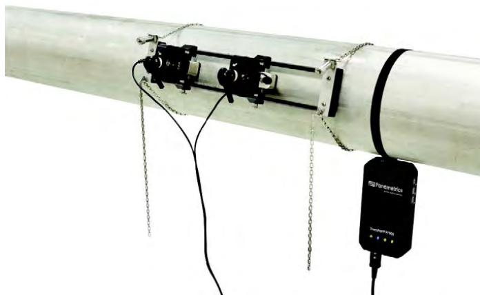
Accesorio de fijación, transductores y transmisor montados en la tubería
